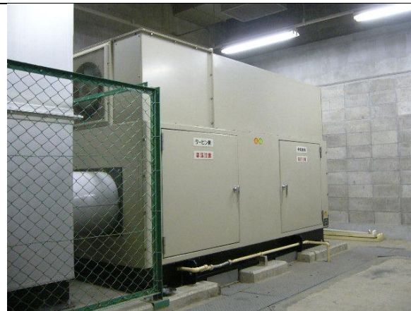
No.2 工場棟内部 自家発電設備
