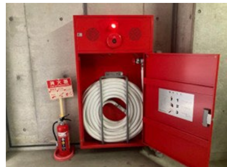
図 9 易操作性 1 号消火栓の例 (当社撮影、著者住宅関連施設)
